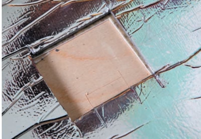
Рис. 23. Отверстие под датчик температуры пола в теплоотражающем материале
